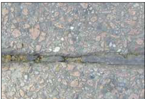
Figura 5: Degrado dei giunti precedentemente sigillati
