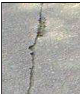
Figura 2: Esempio di fessurazione longitudinale
