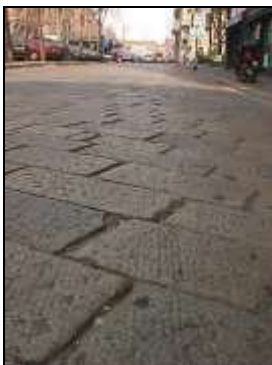
Figura 12: Eccessiva apertura dei giunti non sigillati
