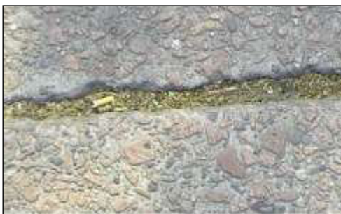
Figura 4: Degrado dei giunti non sigillati
