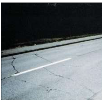
Figura 3: Esempio di fessurazione trasversale
