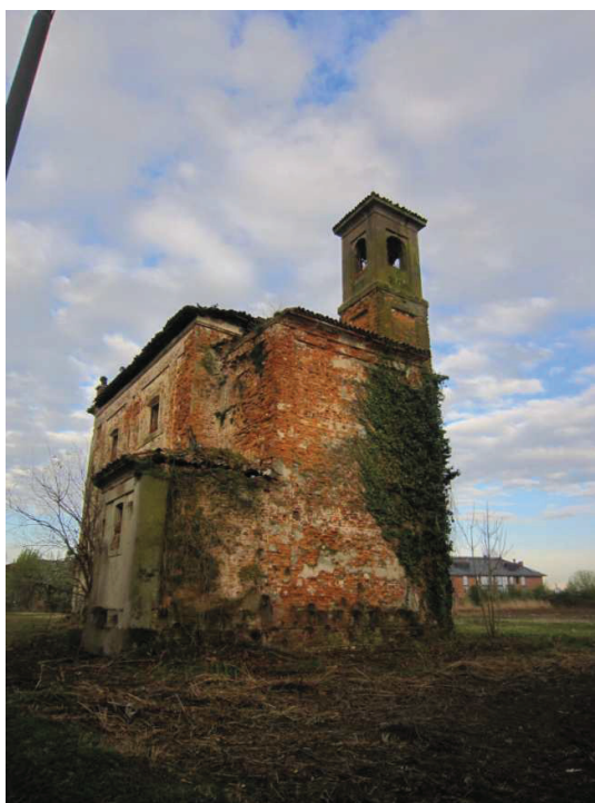
Immagine del degrado raggiunto dalla ex chiesetta di San Carlo"
