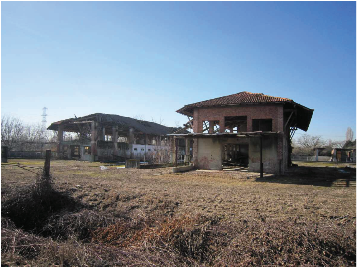
Vista del degrado degli immobili interni alle aree oggetto d'intervento
